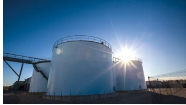
Cuves d'entreposage des EDL.
